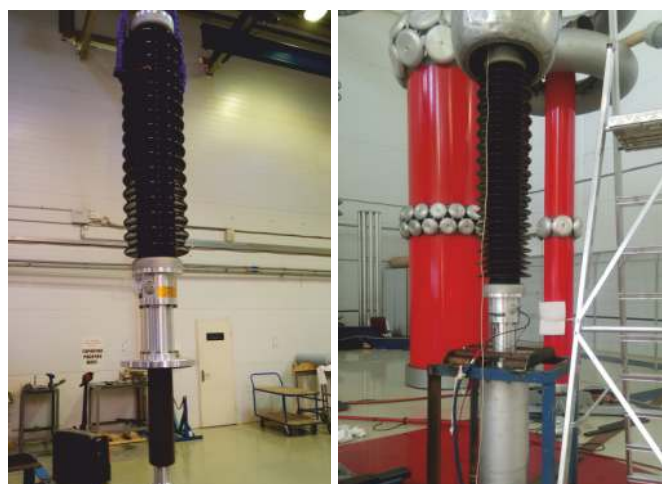
Рис. 19. Ввод «элегаз — воздух» с RIP-изоляцией на испытаниях
