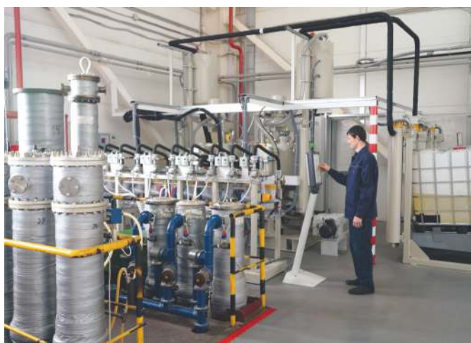
Рис. 16. Машина Hubers для вакуумной пропитки изоляции на заводе «Изолятор»
