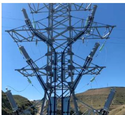
Муфты ИКМ-126 на кабельной линии гидроэлектростанции
