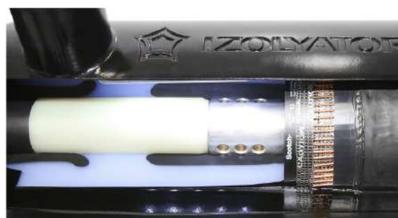
Контакт токопроводящей жилы кабеля с помощью болтового соединителя
