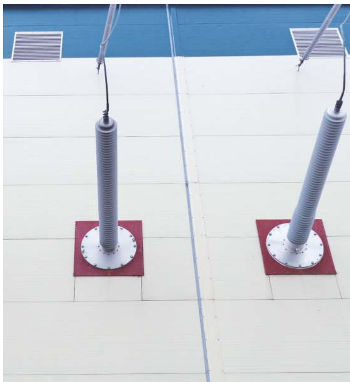
Линейные вводы 220 кВ компании «Изолятор» на распределительном устройстве нефтеперерабатывающего предприятия
