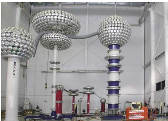
Рис. 20. Участок испытаний вводов 220–1150 кВ на заводе «Изолятор»
