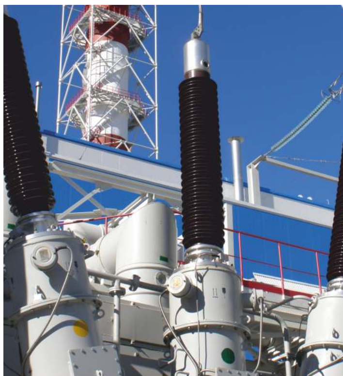
Линейный ввод 820 кВ постоянного тока в испытательном центре компании «Изолятор»
