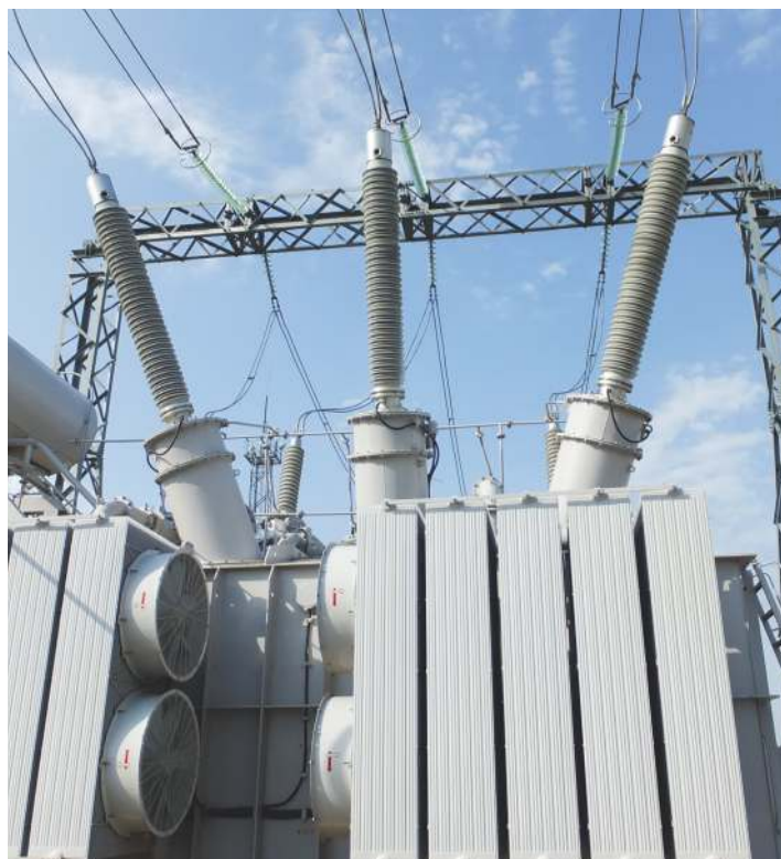
Вводы 330 кВ компании «Изолятор» на трансформаторе магистральных электрических сетей
