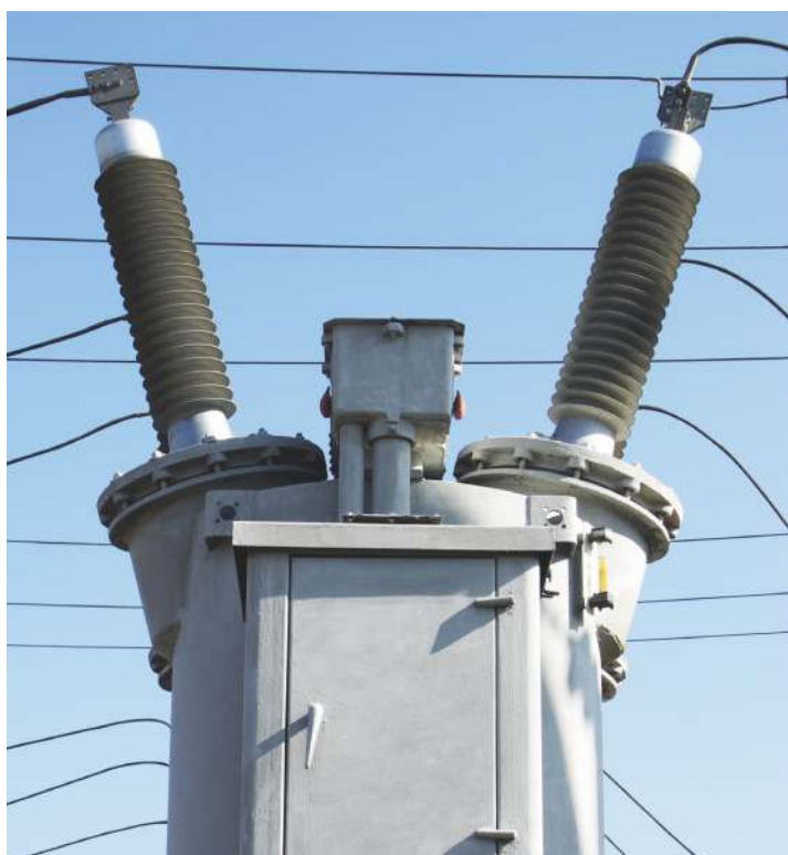
Вводы 110 кВ компании «Изолятор» на масляном выключателе межрегиональной распределительной сетевой компании
