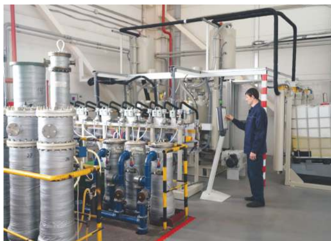
Рис. 19. Машина Hubers для вакуумной пропитки изоляции
