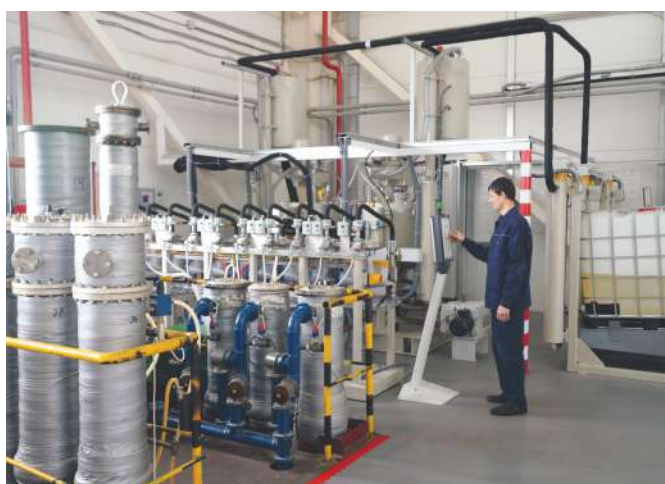
Рис.15. Машина Hubers для вакуумной пропитки изоляции
